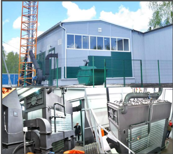
УТПУ-МТ 2х1,5МВт Владимирская обл.
