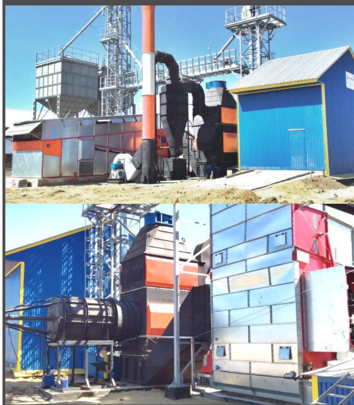
Теплогенератор «ТЕПЛОТОК» 2,4МВт Ростовская обл.
