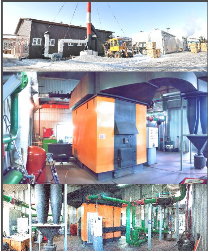
УТПУ-Б 2МВт Владимирская обл.
