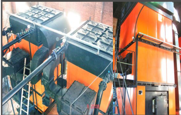
УТПУ-3М/ТЯ 2x2МВт Вологодская обл.
