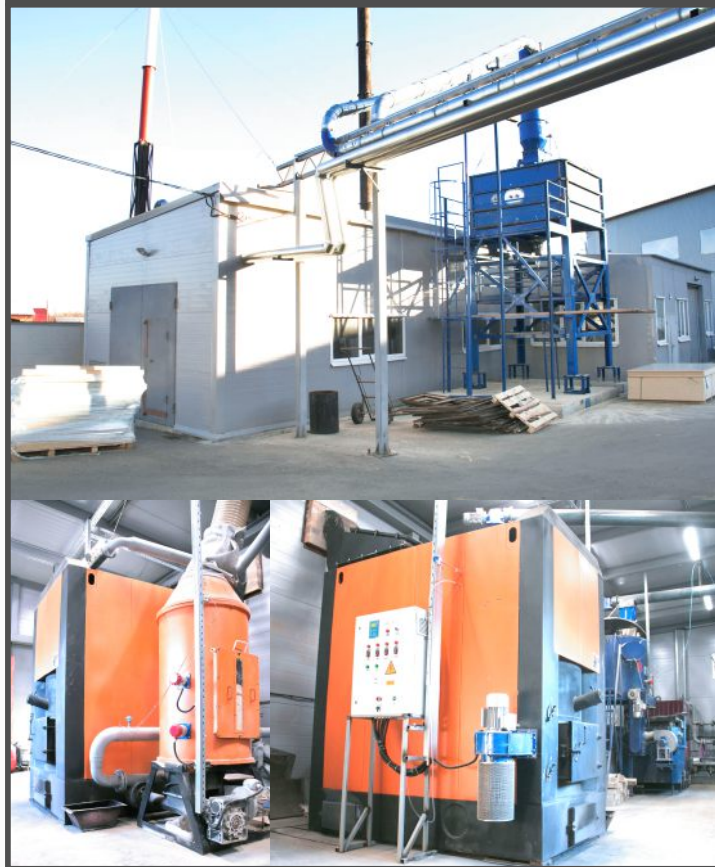
УТПУ-СПК 1МВт Нижегородская обл.
